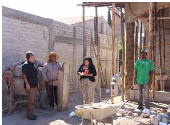
Visita a obra de construcción de la Casa para Museo, Biblioteca y Taller de Artesanías.
