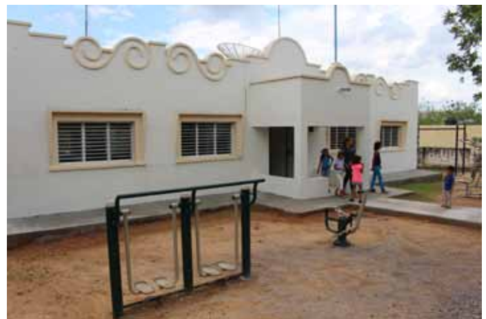
Instalación de gimnasio al aire libre y rehabilitación de la biblioteca pública en la comunidad de La Ensenada.
